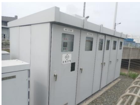
〔図1〕キュービクル（高圧受電設備）
